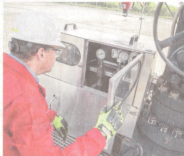
Die Anlage in Goldenstedt läuft vollautomatisch. Nur für Wartungen kommen Menschen auf das Gelände.
